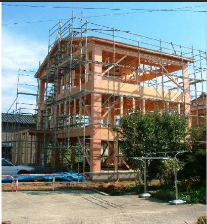
2004.10月中越地震 震度6強 仮筋交いの状態で問題なし
