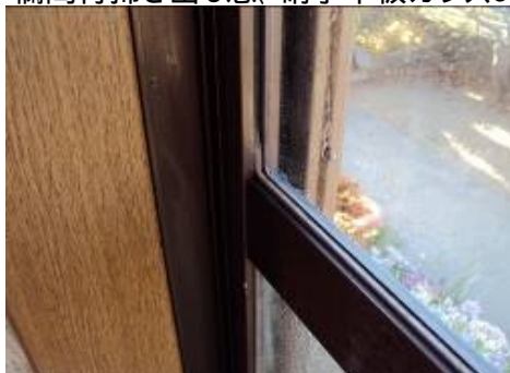
現状窓枠との納まりと結露の様子 2010/01
