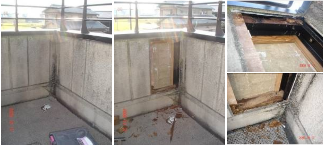
雨漏りらしい形跡があったので一部外装材をめくってみました
