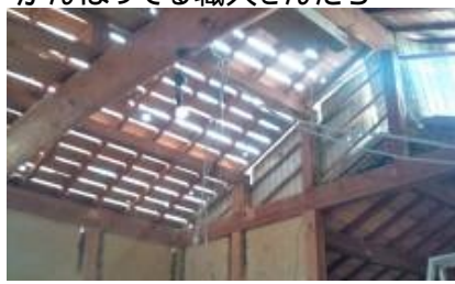
屋根が完全めくれ、野地板だけに。
